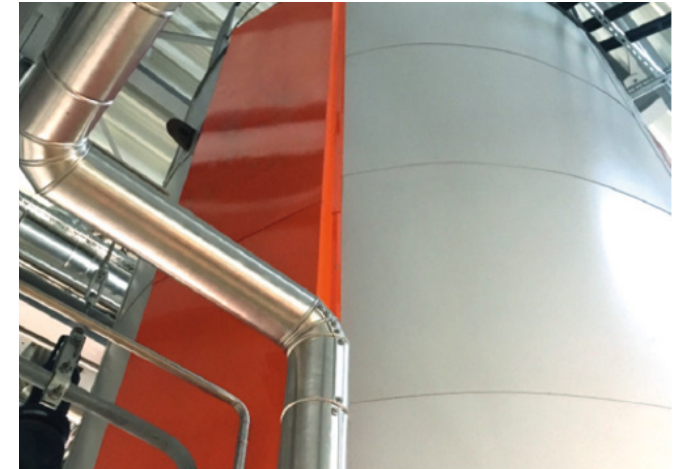
Neue Power-to-Steam-Anlage im Werk Hamburg
